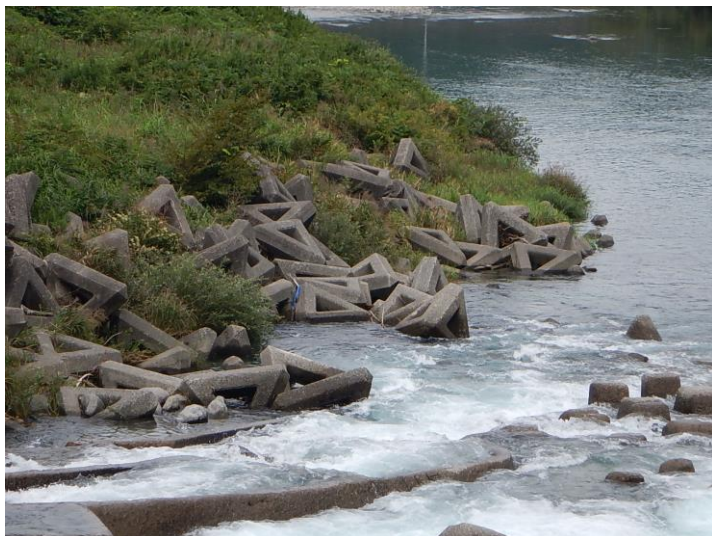
護床ブロック
