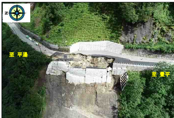
写真2 - 1 被災箇所周辺の斜面状況
