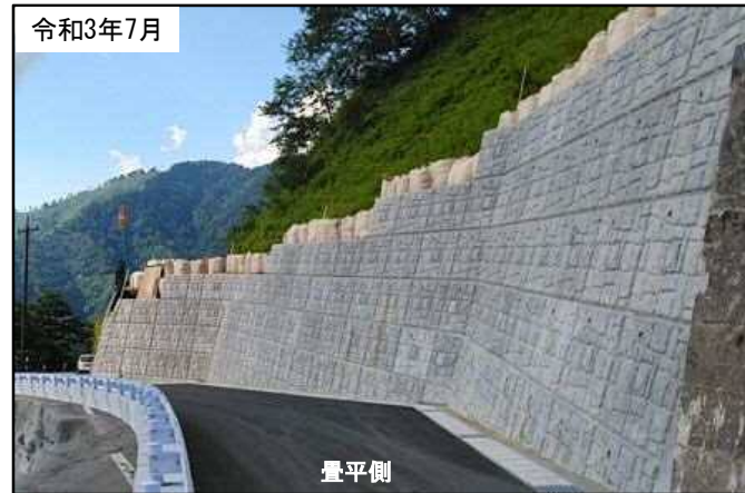
切土補強壁面（復旧構造）に明瞭な湧水跡は確認できない
