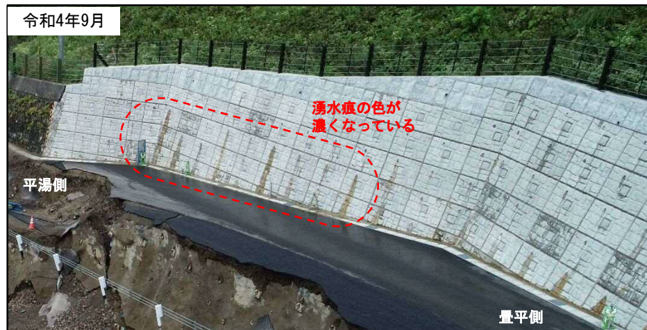
切土補強のほぼ全体に湧水痕が確認できるが、平湯側は高い位置からの湧水痕が色濃くなっている
