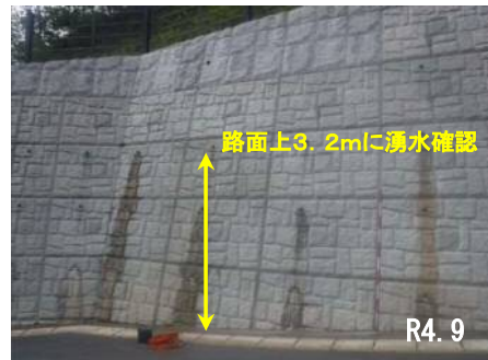
被災直後の山側擁壁部地下水状況
