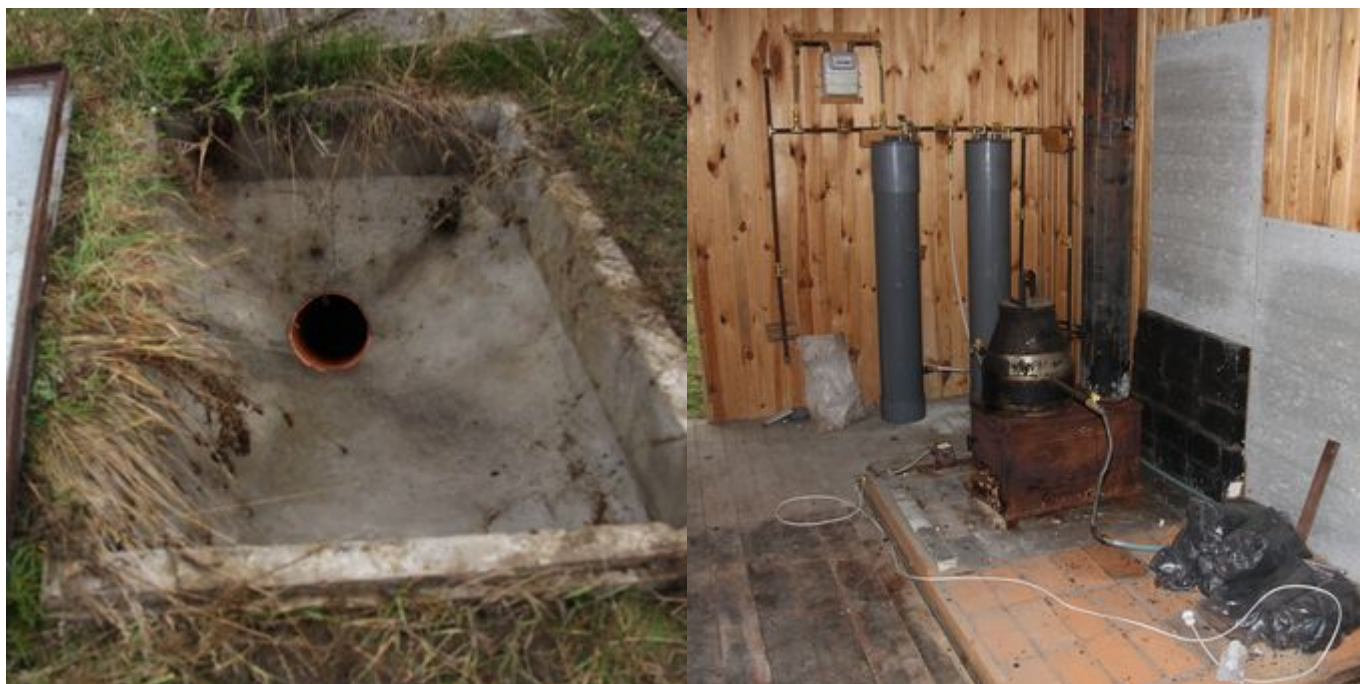
左：バイオガス原料投入口 右：施設内部
