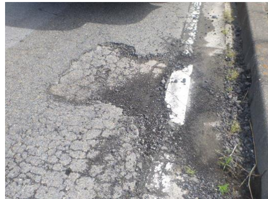
写真 2-2 穴ぼこ発生状況(2)
