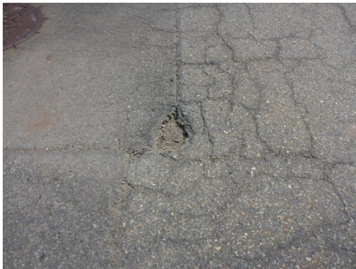
写真 2-1 穴ぼこ発生状況(1)
