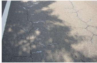
写真 4-2 路面状態（予防保全）
