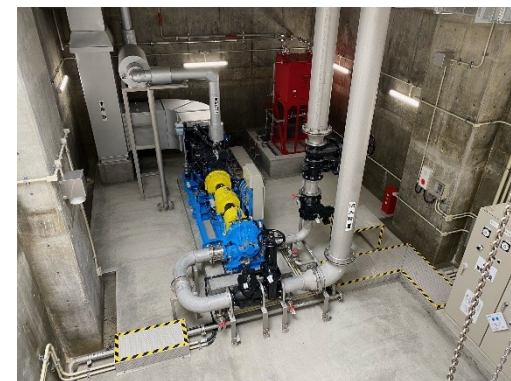
釜戸緊急時増圧ポンプ場 (令和4年度完成)
