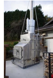
バイオマスボイラー (恵那市花白温泉)
