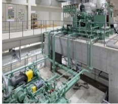
木質バイオマス発電(瑞穂市) 参照: (株)岐阜バイオマスパワー (http://www.bio-gifu.co.jp)
