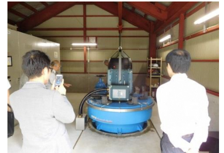
平成29年9月5日 石徹白小水力発電設備見学
