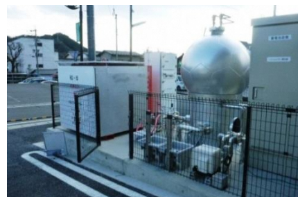
防災機能付き純水素型燃料電池システム(八百津町)
