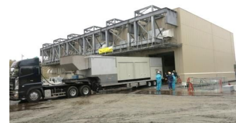
ガスタービン発電機
