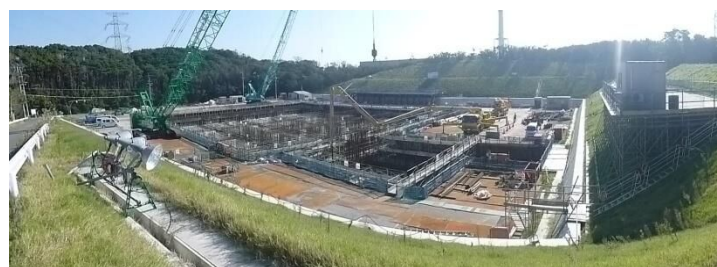
緊急時淡水貯槽
