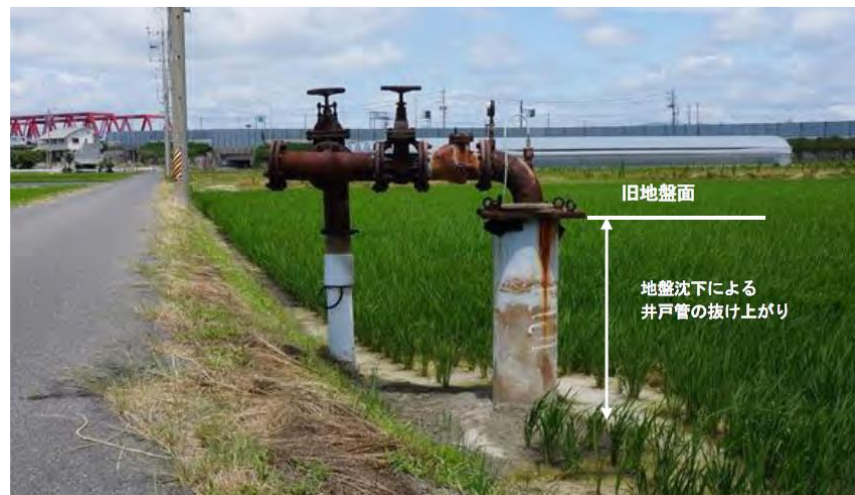
井戸の抜け上がり(三重県木曽岬町 H26.6月) 東海三県地盤沈下調査会より
