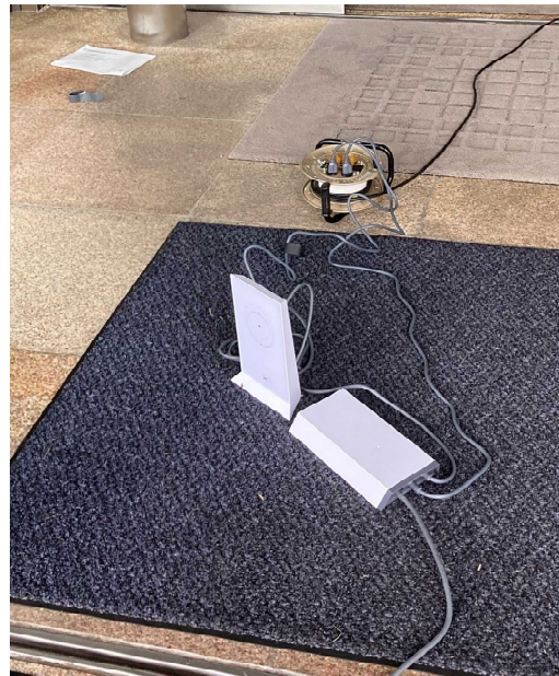
スターリンク衛星を介したインターネット接続用の専用無線LANとアンテナ電源
