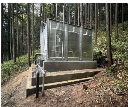
増設した給水槽
