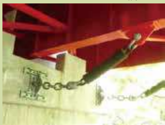
対策事例：落橋防止装置の設置
