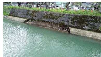
ドローンにより破損箇所を確認した例
