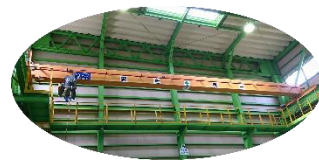
床上操作式クレーン
