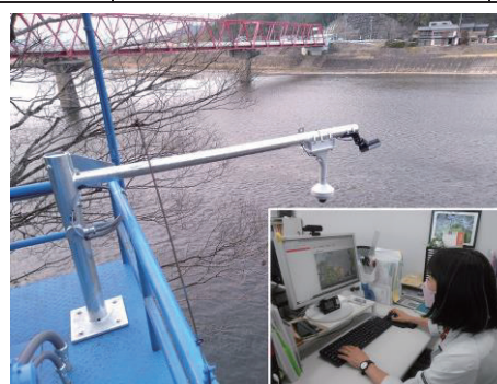
ゲートの遠隔監視
