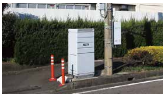
信号機電源付加装置
