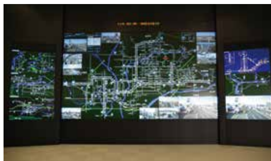
交通管制センター
