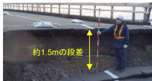
道路と橋梁の間で発生した段差
