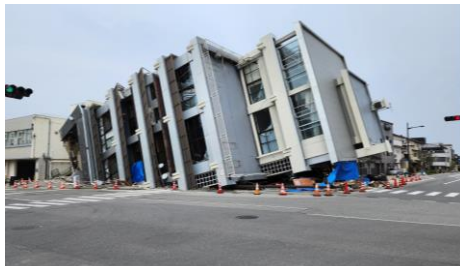
〔倒壊したビル〕
