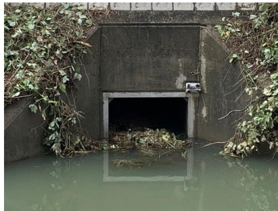
大谷川 右岸樋管 ゲート脱落状況
