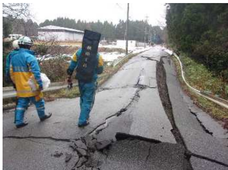
道路損壊状況
