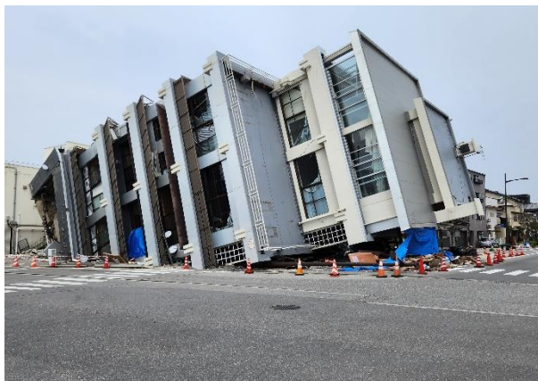
倒壊したビル
