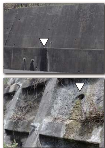
地下水の流出
