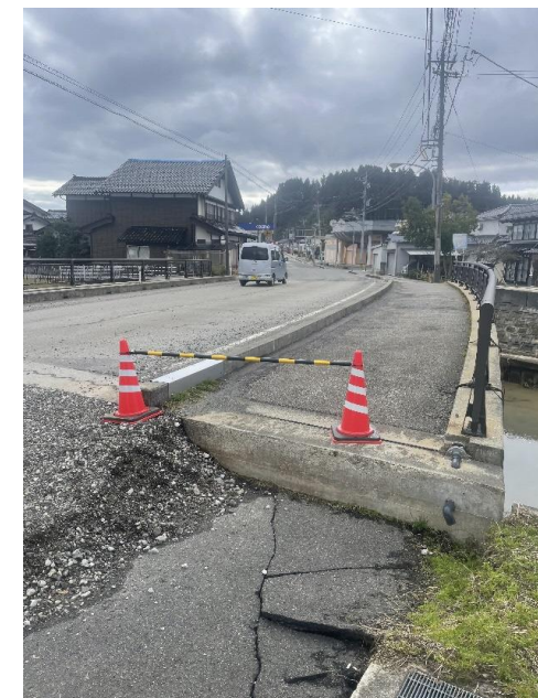
道路の損壊状況
