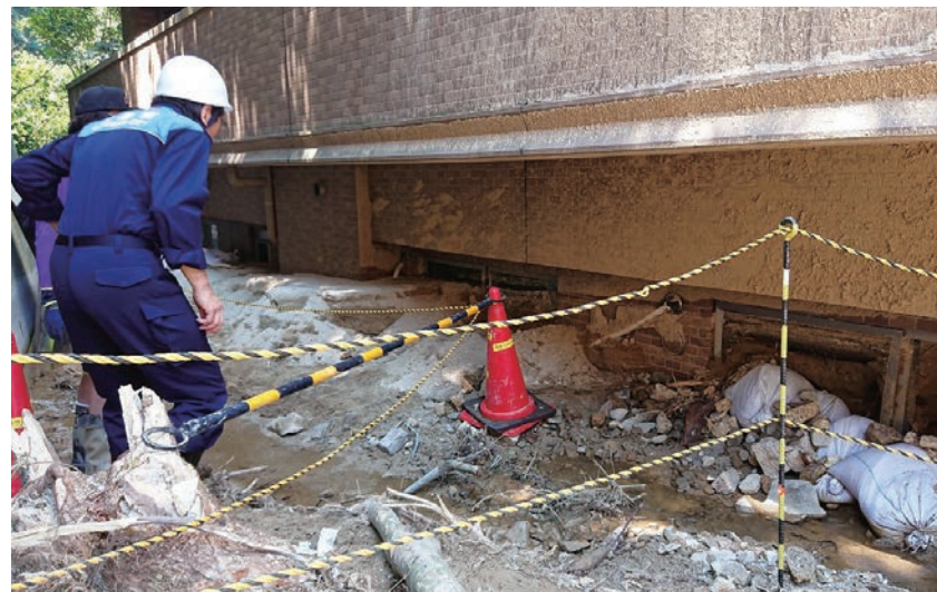
土砂災害により1階部分が埋まった家屋 平成30年7月豪雨災害(広島県海田町) 写真提供: 広島県海田町
