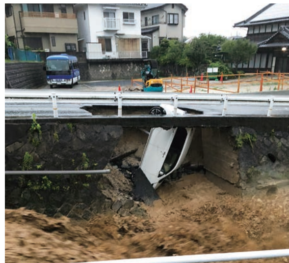
道路陥没により転落した車 平成30年7月豪雨災害(広島県海田町) 提供:広島県海田町
