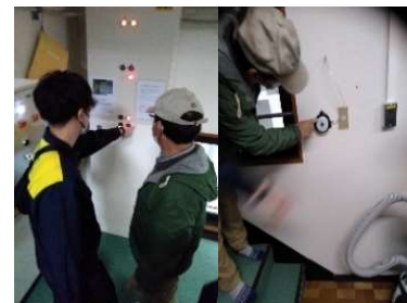
(写真4) 陽圧化装置の起動確認
