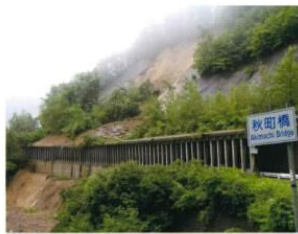
尾神地内 国道156号法面崩壊
