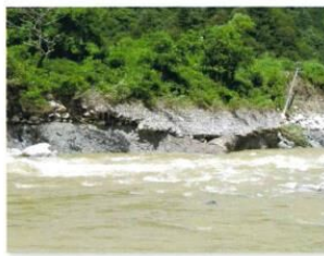
御母衣地内 護岸決壊
