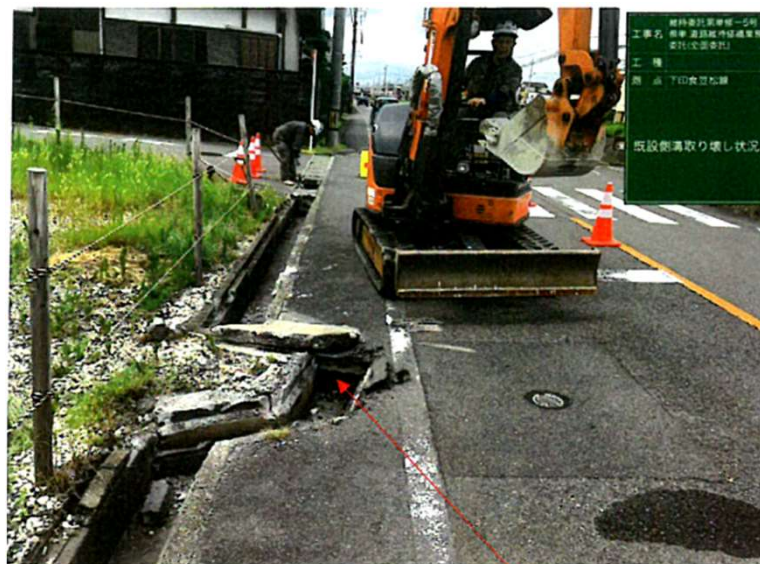
ガス管破損箇所
