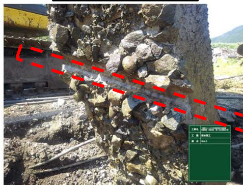
水道管付着状況
