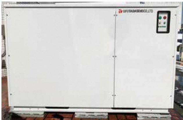
岐阜多田精機製 VRFB2 号機
