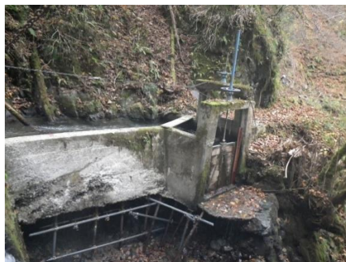
老朽化した用水施設
