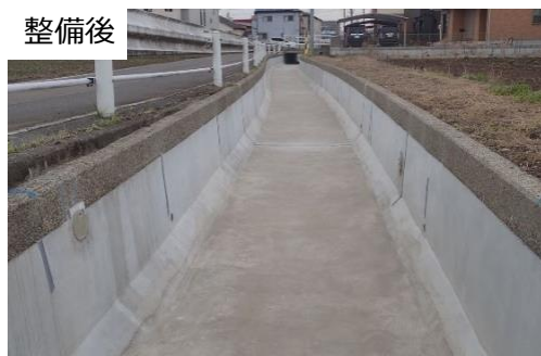
農業用水路の予防保全対策 (関市 曾代用水四期地区 曾代用水)
