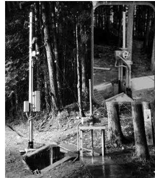
ゲートの遠隔監視・操作
