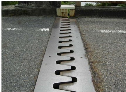
継手部の異常の確認
