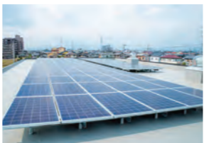
屋上に設置した太陽光パネル
