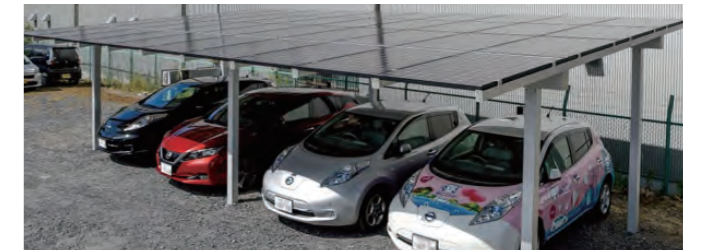
ソーラーチャージャー(カーポート型太陽光発電所)
