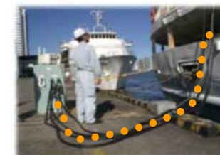
電力供給設備
