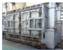
Li-ion電池 リサイクル設備
