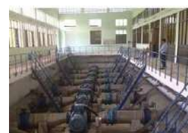
高効率ポンプ (ベトナム)
