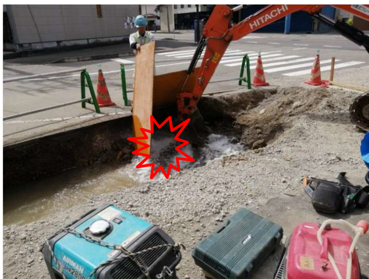
事故直後の状況写真
