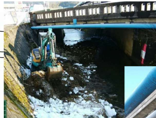
事故現場状況写真
