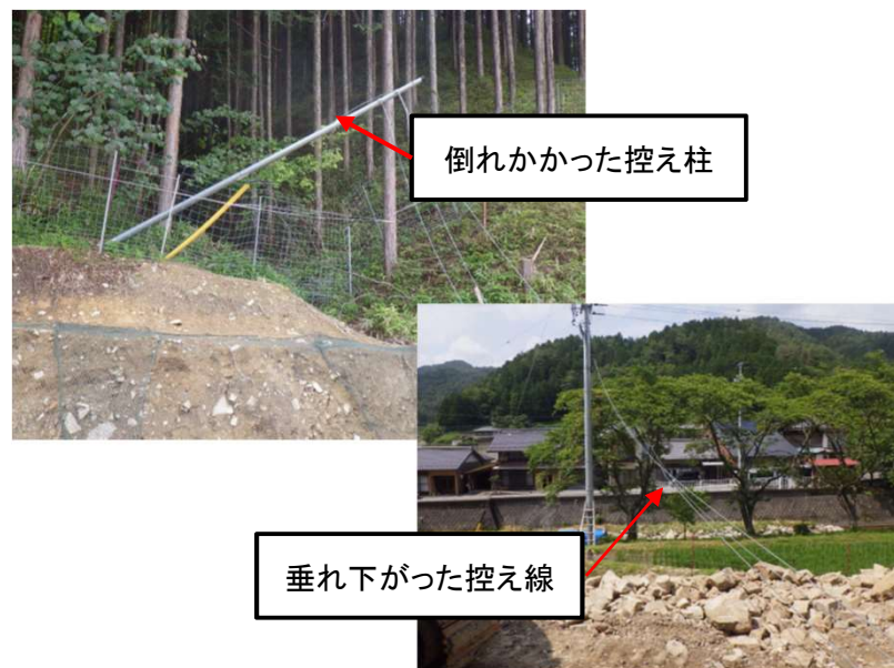
事故現場状況写真
