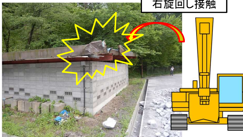
事故現場状況
