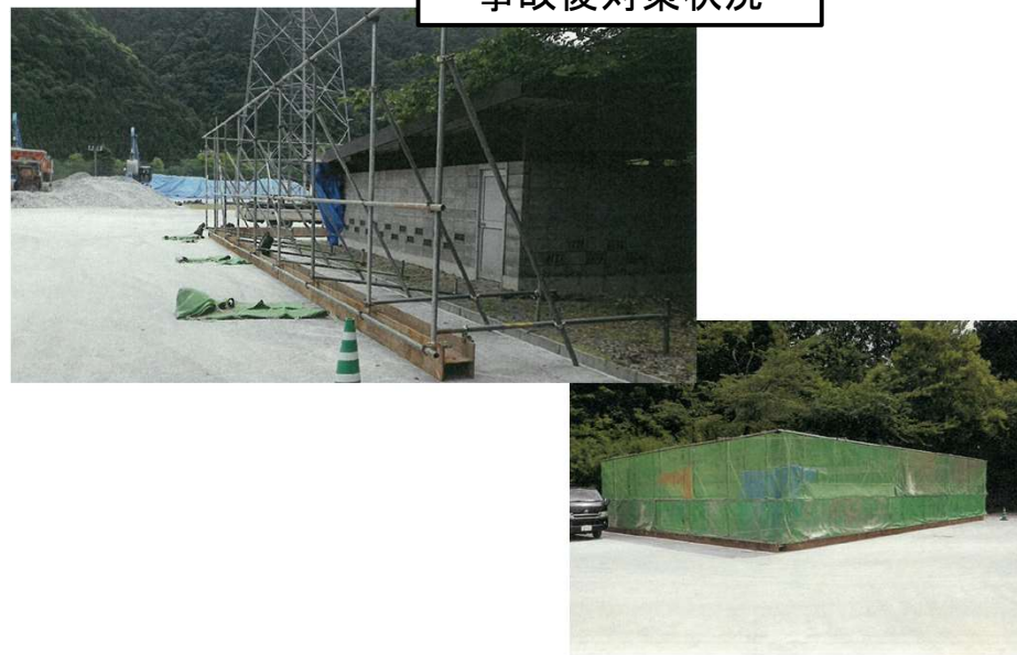
事故後対策状況
