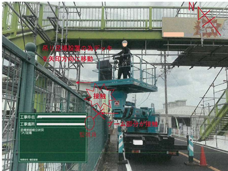
事故現場状況写真1
