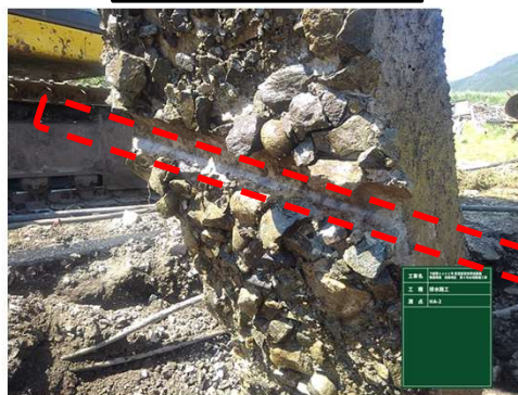
水道管付着状況
