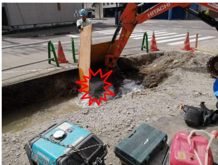
事故直後の状況写真
