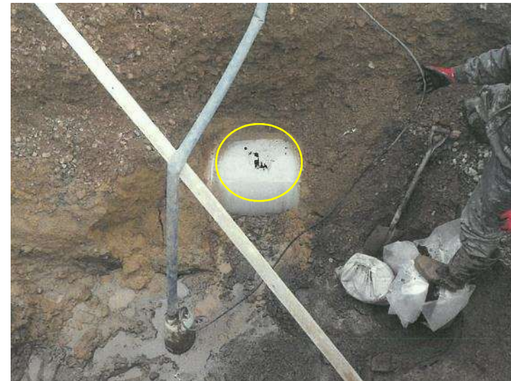
管の破損状況写真
