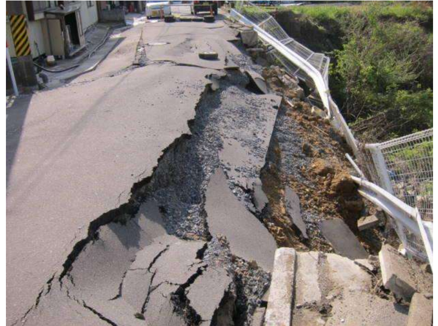
道路被害の状況(宮城県牡鹿郡女川町)
