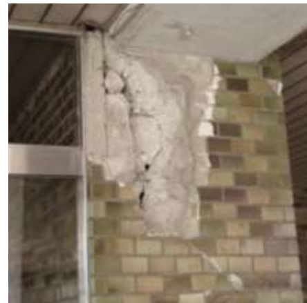
柱の損傷状況 (仙台市富沢駅周辺)
