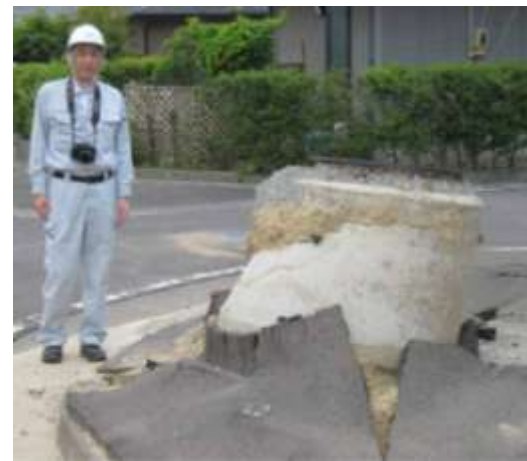
地盤液状化によるマンホールの浮き上がり (宮城県白石市緑が丘付近) ※岐阜大学地震工学研究室提供
