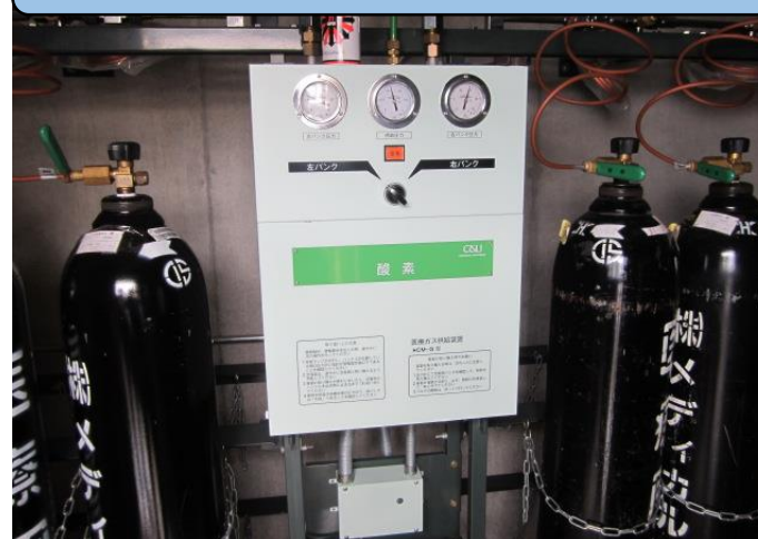
酸素ボンベ（マニホールド室）
