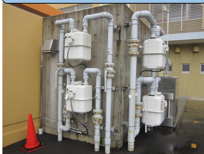
都市ガス配管設備（厨房前）
