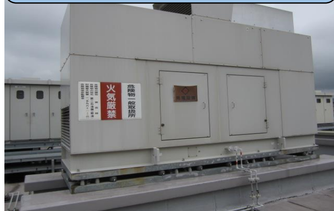
停電時に稼働し、非常用電気を供給する自家発電設備（屋上）
