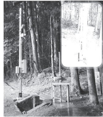
ゲートの遠隔監視・操作
