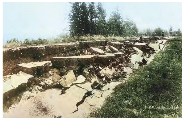
木曽川堤防破壊 原画提供：岐阜地方気象台 堤防にたくさんのきれつが入り、崩れました。
