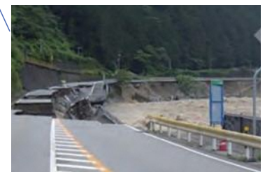
ほうかい げろ 道路崩壊（下呂市 2020年）
