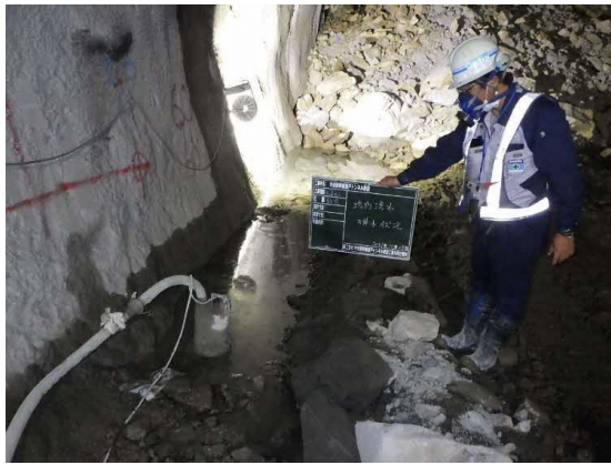
排水処理状況
