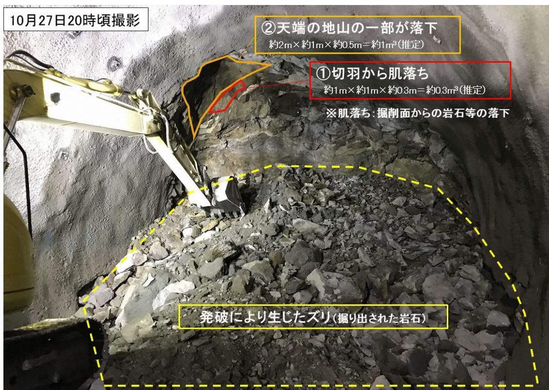
図1-1 災害現場の状況（令和3年10月27日 現在）
