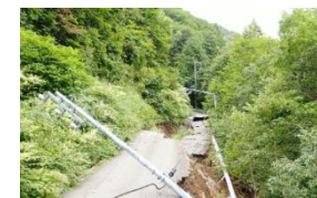
① 県道奈川野麦高根線／ 路側崩壊 (高山市高根町)
