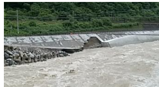
④ 国道41号／路側欠壊 (下呂市小坂町門坂)
