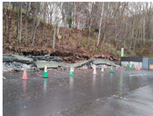
事故発生状況
