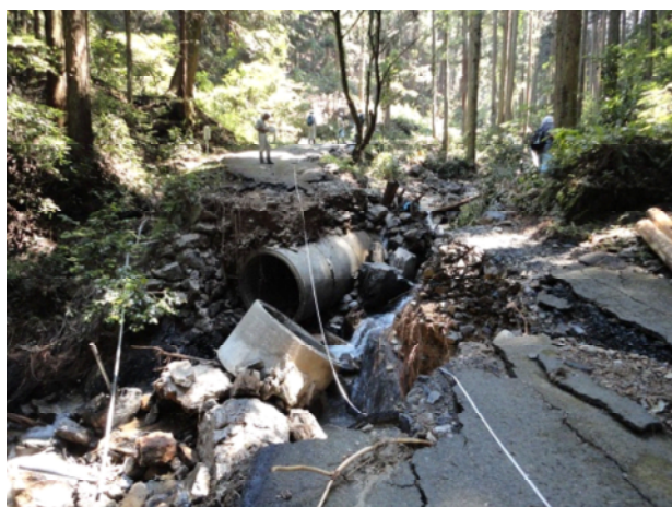
崩壊した林道( 御嵩町：柏森線 )
