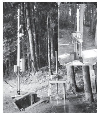
ゲートの遠隔監視・操作
