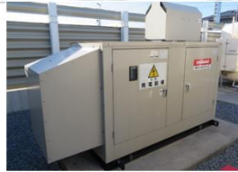
無停電化(非常用発電設備)
