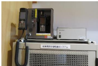
通信機器(防災無線)
