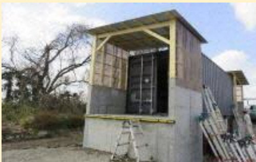
コンテナを活用した出荷デポ
