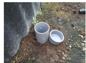
【地下水位測定の管】
