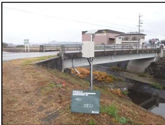
危機管理型水位計 (蜂屋川 美濃加茂市)
